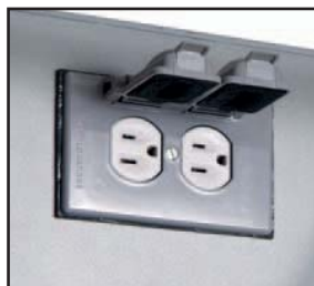
115 Volt AC Power Outlets
